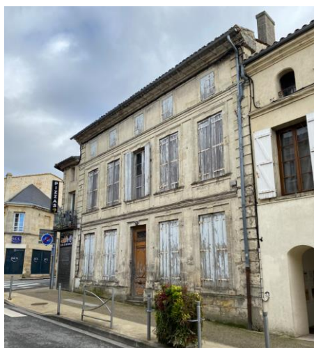
Façade dégradée // crédit photo MERC/AT
