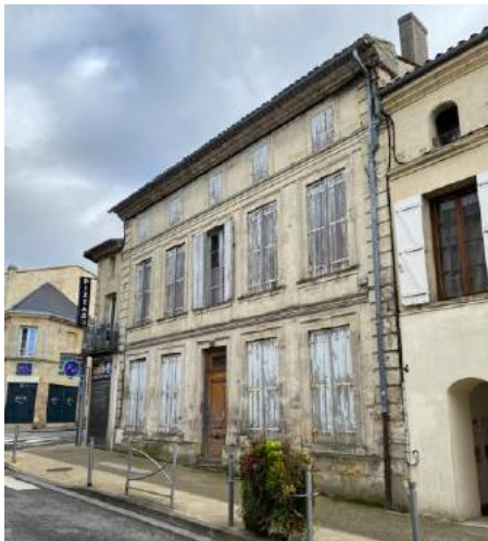
Façade dégradée // crédit photo MERC/AT
