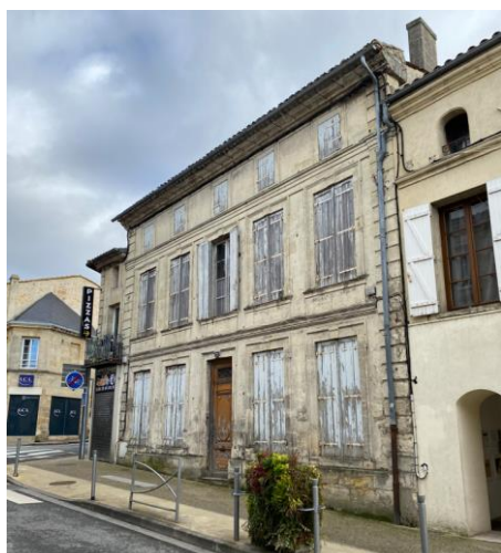
Façade dégradée // crédit photo MERC/AT
