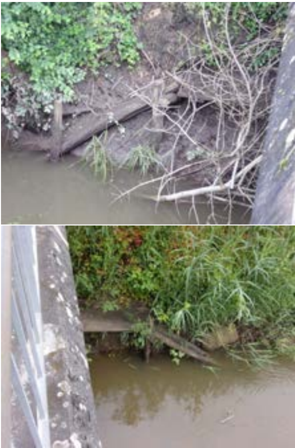
Photo 6: Dispositif de franchissement sous pont de la RD137E6
